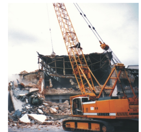
Einsatz eines Seilbaggers im Zuge der entsorgungstechnischen Abbruchbegleitung des Glaswerkes Bernsdorf (Sachsen)
