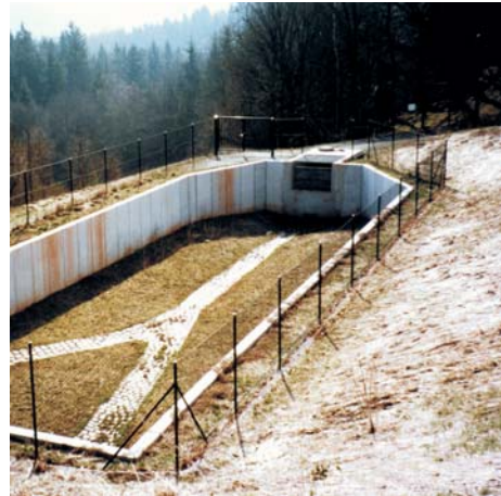
Lietaus vandens surinkimo rezervuaras
