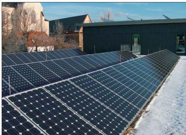
Photovoltaikanlage zur Stromerzeugung auf den Dächern der M&S-Firmenzentrale
